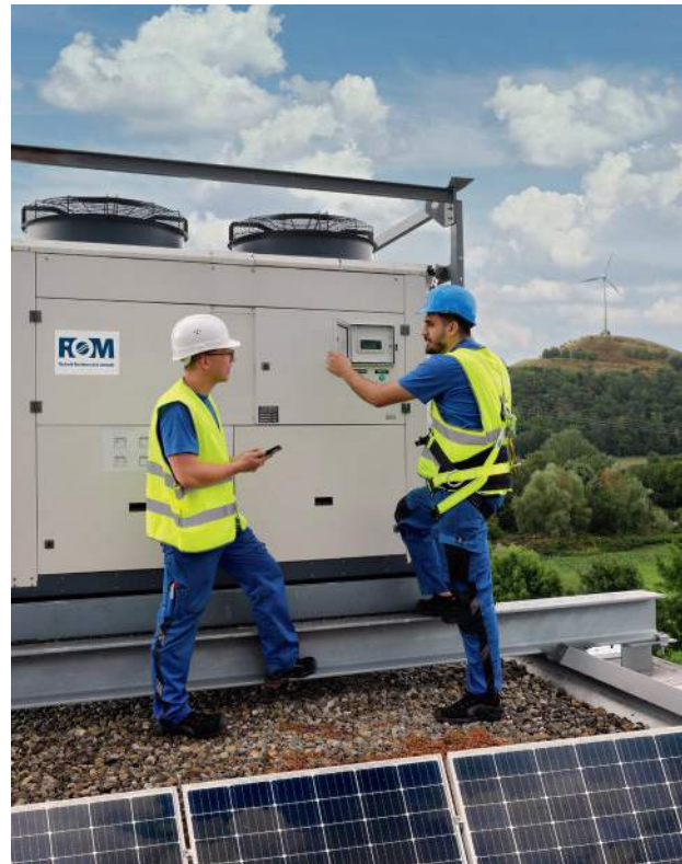
Klimaanlagen bieten erhebliche Energiesparpotenziale
