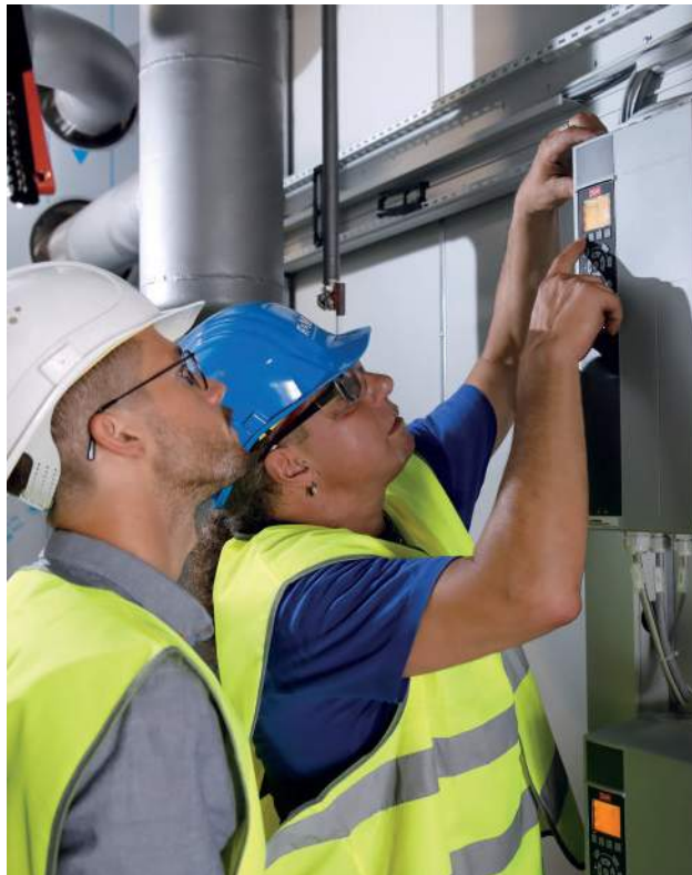
Betriebsstunden und Energiebedarf eines Ventilators werden ermittelt
