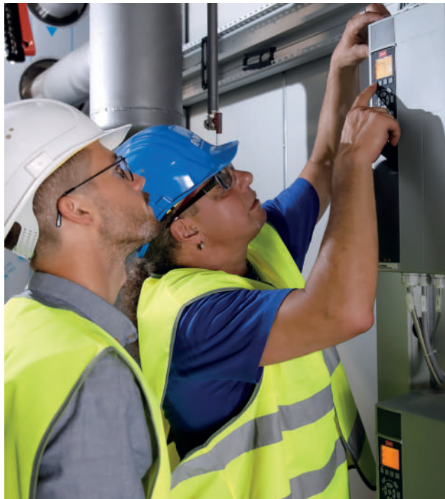
Betriebsstunden und Energiebedarf eines Ventilators werden ermittelt
