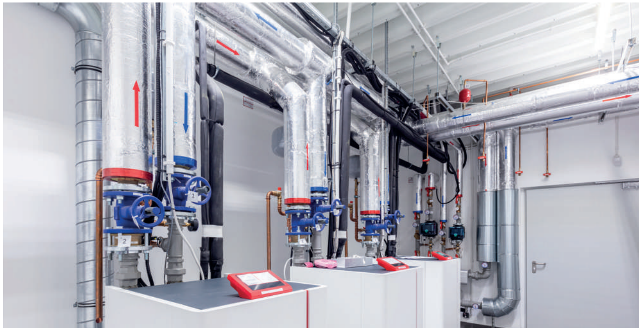
Mit dem Aufbau kaskadierter Wärmepumpen wird der individuelle Wärmebedarf optimal bereitgestellt
