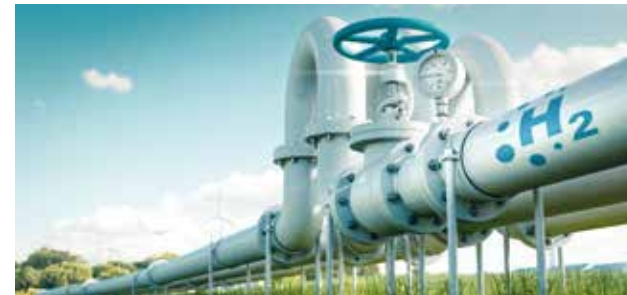
Transportleitungen für Gas/H 2
