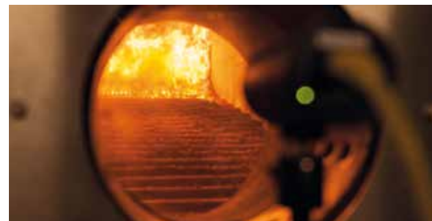
Kontrollöffnung im Feuerraum eines Biomasse-Kessels
