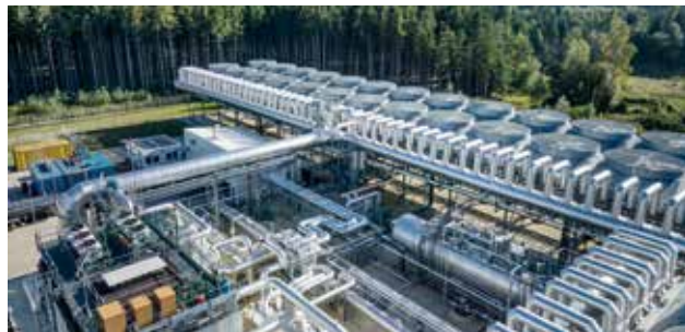
Geothermieprojekt Turboden im Süden Bayerns
