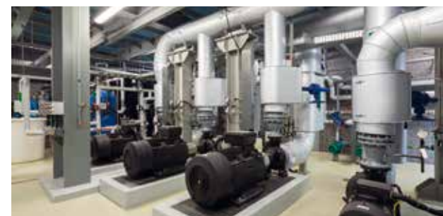
Netzpumpenanlage zur Fernwärmeversorgung
