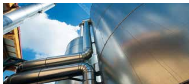
Hydraulische Anbindung der Pufferspeicher
